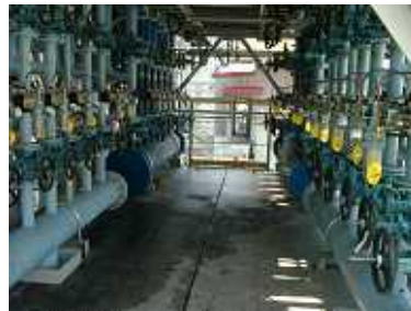
溶銑冷却水用バルブスタンド
